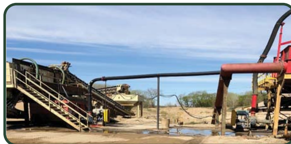
Nueva ubicación de la bomba de arena.
